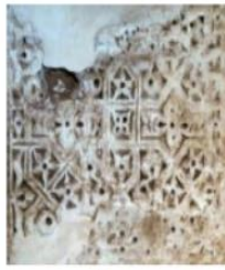
تصویر ۱۹-۱. دیوار روبروی طاقنما، محراب گچبری صومعه‌ی بایزید بسطامی، اتاق (۳) (مأخذ: نگارندگان)
